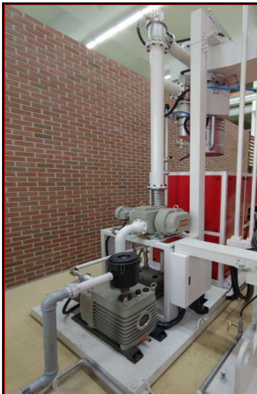
真空排気装置
